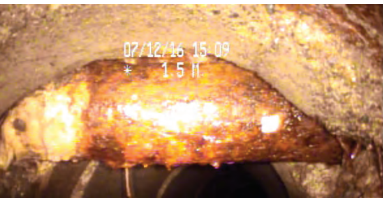
L'inspection en CCTV a révélé plusieurs zones préoccupantes dans les égouts, y compris des sections où les conduites d'eau traversaient carrément les égouts.
